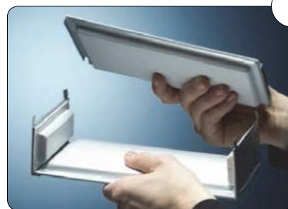
6 Boxen werden auseinander genommen, um die Kabel gelegt und wie beschrieben eingemörtelt.
